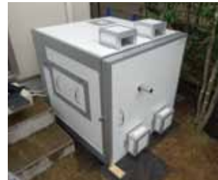
発電機の防音ボックス
